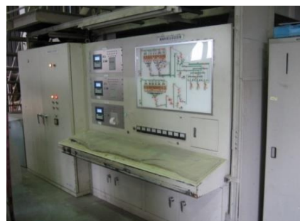
●総合コントロールパネル
